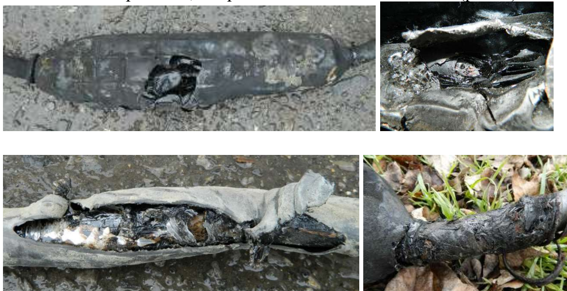
Рис. 1. Внешний вид пробоя в силовом кабеле
